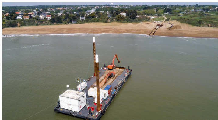
Chantier de raccordement du parc éolien au large de Saint Nazaire (avril 2020) © RTE
